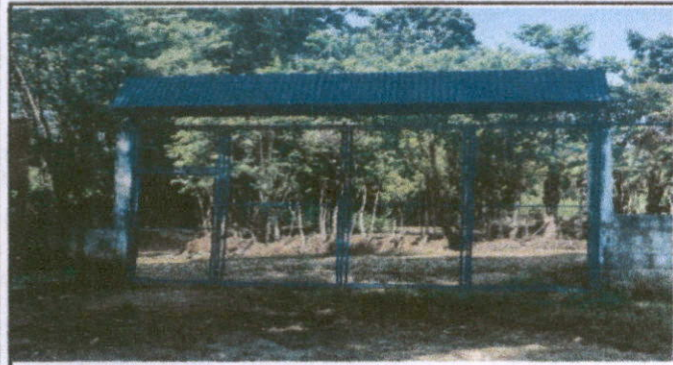
Foto 1: Pintura en portón de la entrada principal
